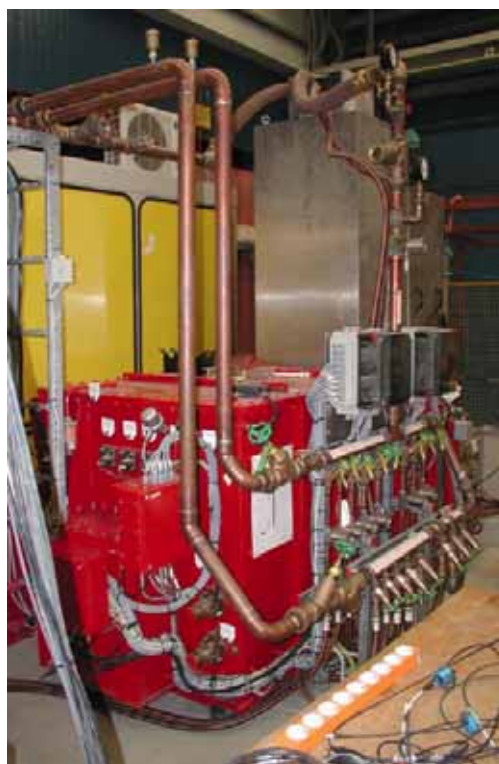
Fig.3.4 ABB 社製パルス変圧器
