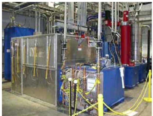
Fig. 6.7 SNS コンバータ方式電源の外観
